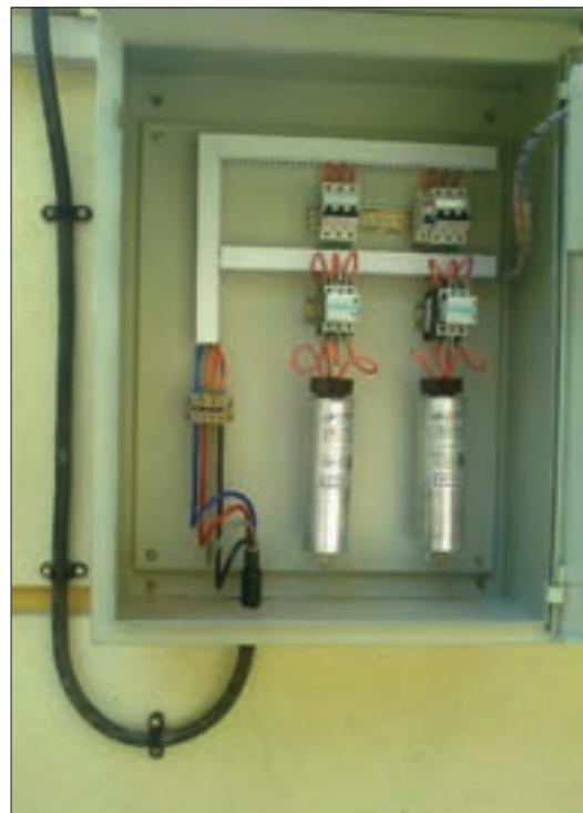
شکل ۲- تابلو بانک خازنی
