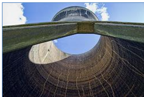
شکل ۴۵- برج خنک کننده از داخل
