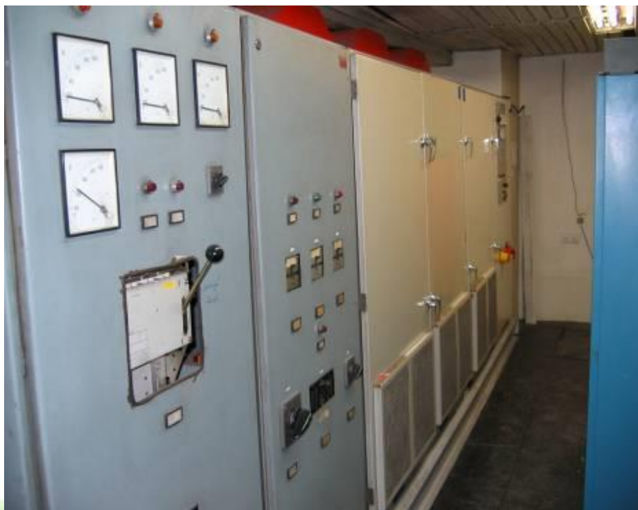
یوپی اس و تابلو برق ورودی شهر
