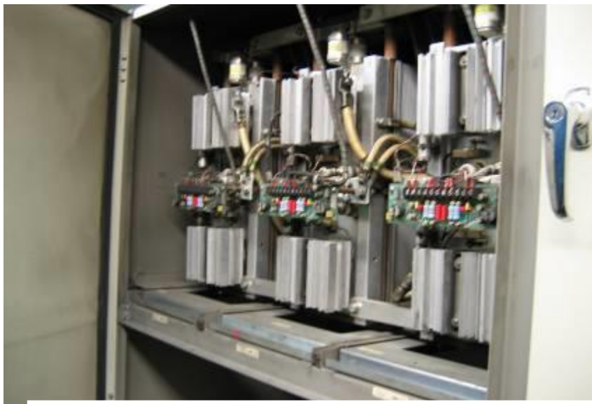
اینورتر UPS 400KVA امرسون با هیت سینک
