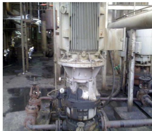
بوسترپمپ های قدیم
