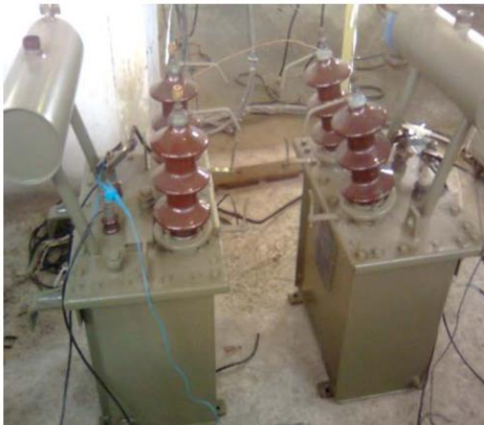
شکل ۱- نحوه قرارگیری ترانسفورماتور برای انجام آزمایش
