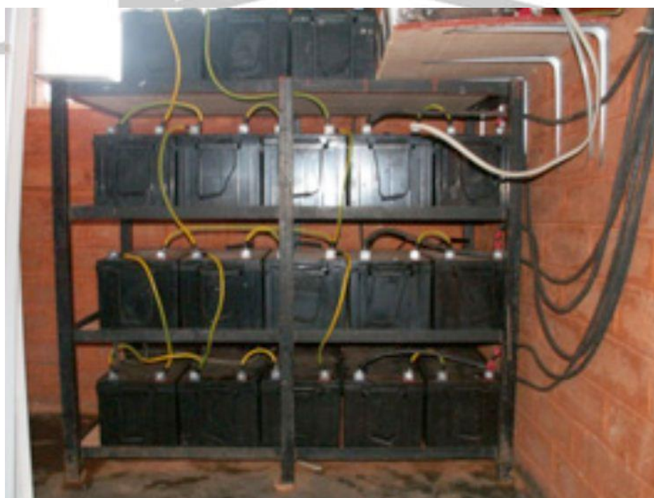
شکل ۳-۵۴ اتاق باتری‌ها (باتری خانه) و باتری‌های سری و موازی شده
