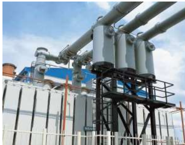
شکل ۱۱-۱۸: برقی های GIS که به یک باس بار GIS ۴۲۰ کیلوولت متصل شده است.
